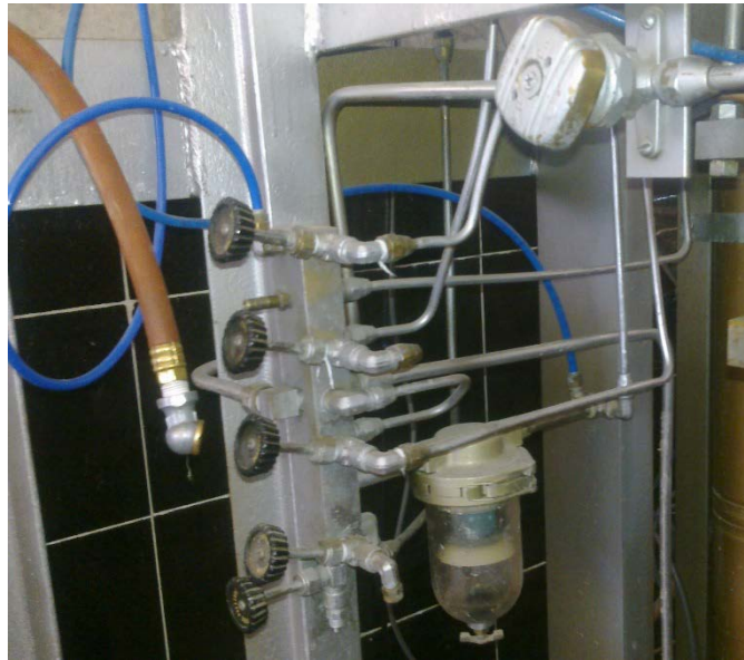
Figura 11 Red de tuberías de la máquina Triaxial Chicago Soiltest.
