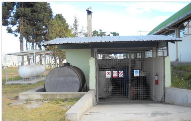
Figura 52. Caldera de la piscina semiolímpica
