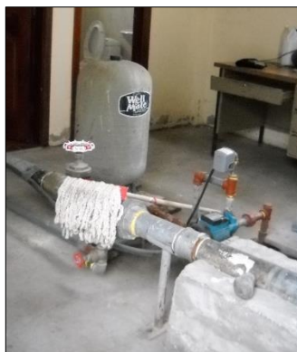
Figura 15. Bomba de agua
