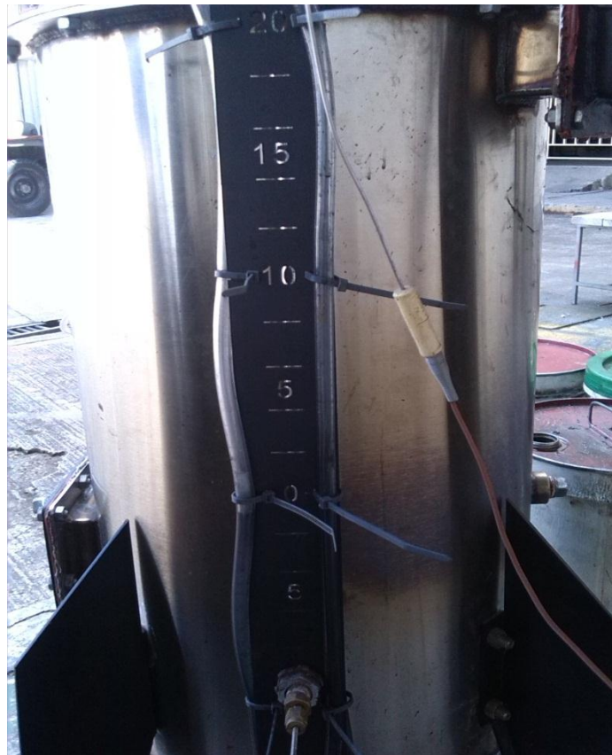
Figura 43 Foto manómetros de agua
