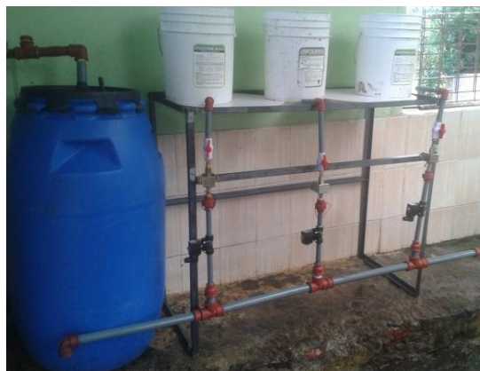
Figura 5.9 Dosificadores del sistema CIP.
