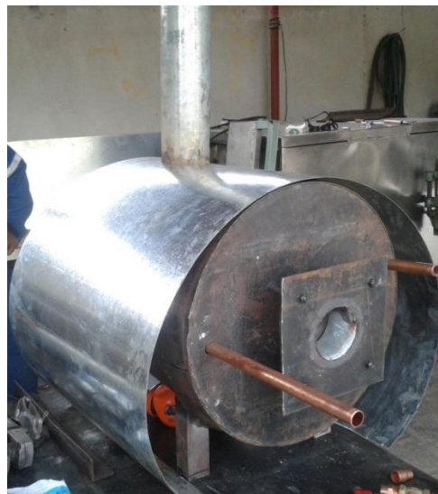
Figura 5.4 Forro del tanque de calentamiento.
