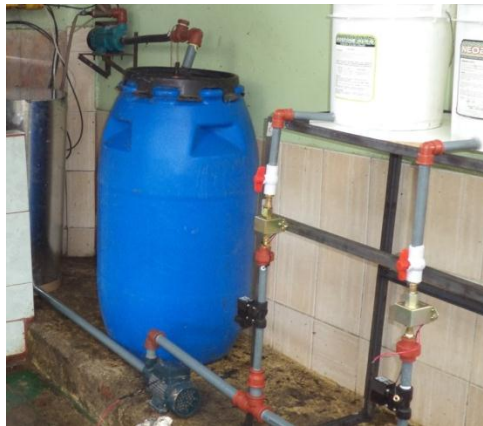
Figura 5.10 Bombas de recirculaciones en el sistema CIP.
