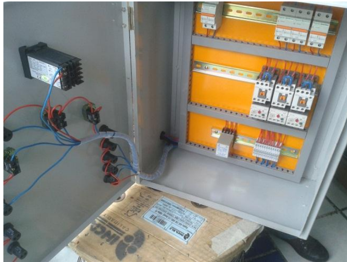
Figura 5.11 Disposición de los elementos de control eléctrico.
