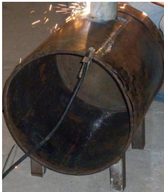
Figura 5.2 Cuerpo interno del tanque de calentamiento.
