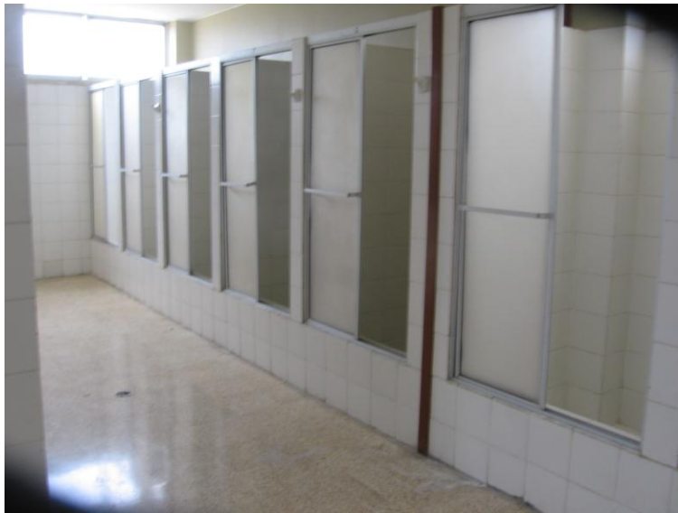
Fotografía 5. Duchas de la villa #3
