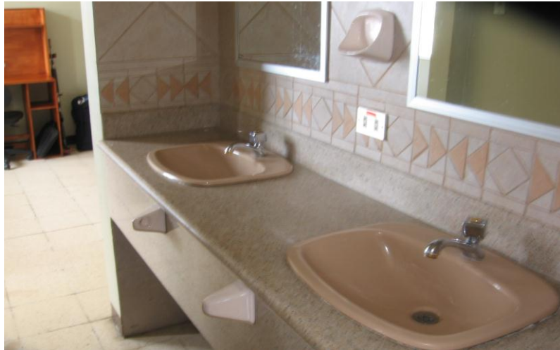
Fotografía 2. Lavamanos de la villa #2
