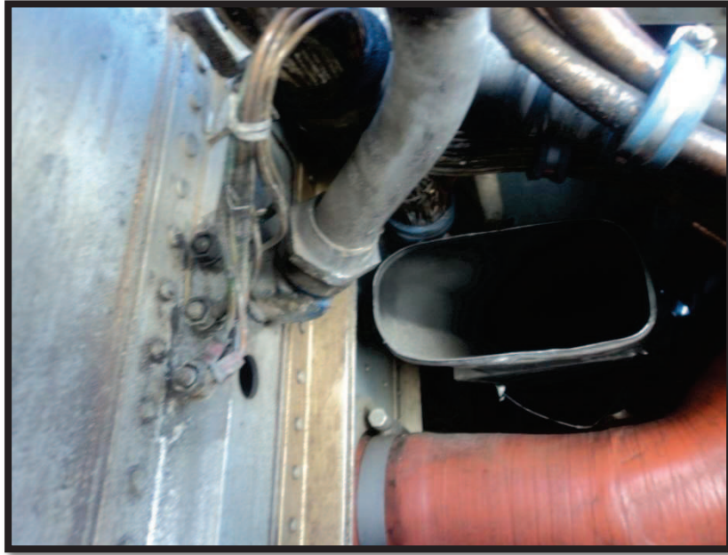
Figura 3.11. Líneas de combustible y tubos de ventilación (Botas).
