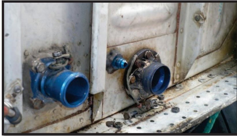
Figura 3.5 Cañerías de conexión
