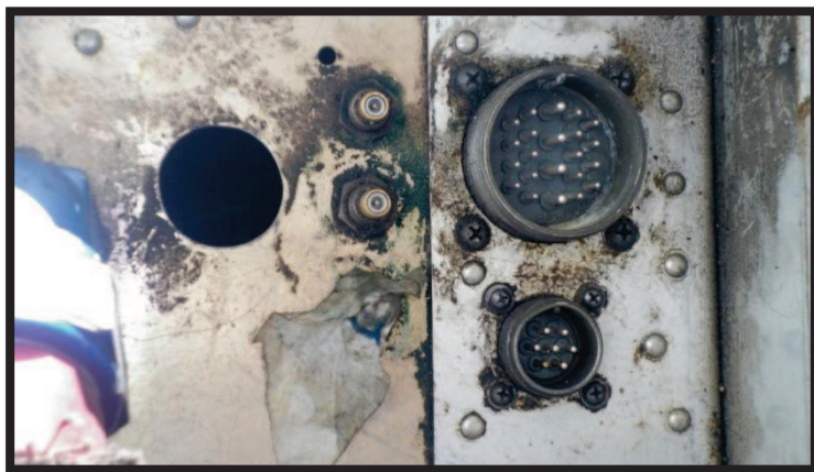
Figura 3.8 Punto de conexión del sistema eléctrico
