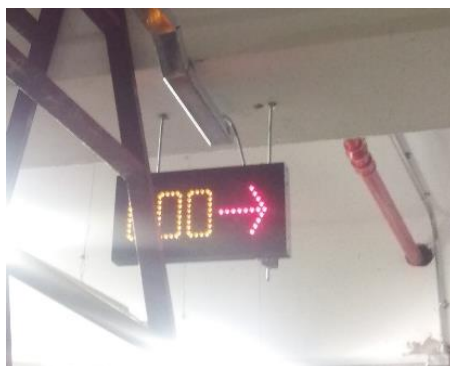
Figura 6.3 Display muestra los espacios disponibles en el parqueadero.
