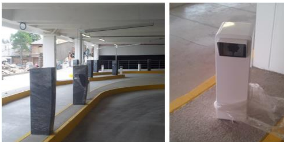
Figura 4.2 Instalación de emisor, barrera y cámara (LPR)
