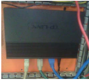
Figura 146. Switch TL-SG1005D instalado en el tablero de control
