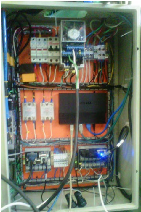
Figura 143. Tablero de Control
