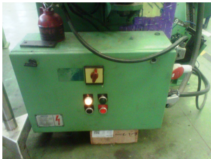
Figura 235. Tablero de control principal de la máquina de pesaje
