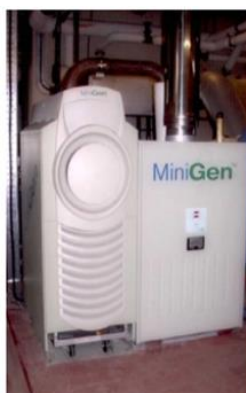
Figura 41. Micro turbinas de gas
