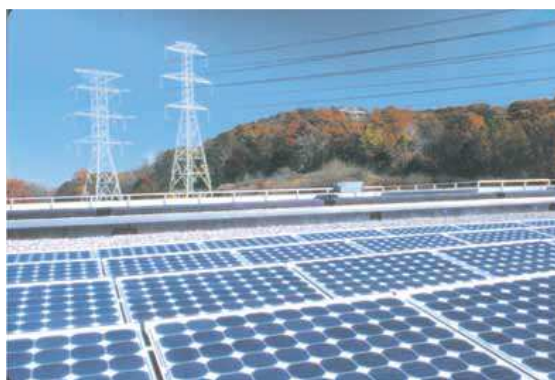
Figura 2.2: Energía solar en planta fotovoltaica
