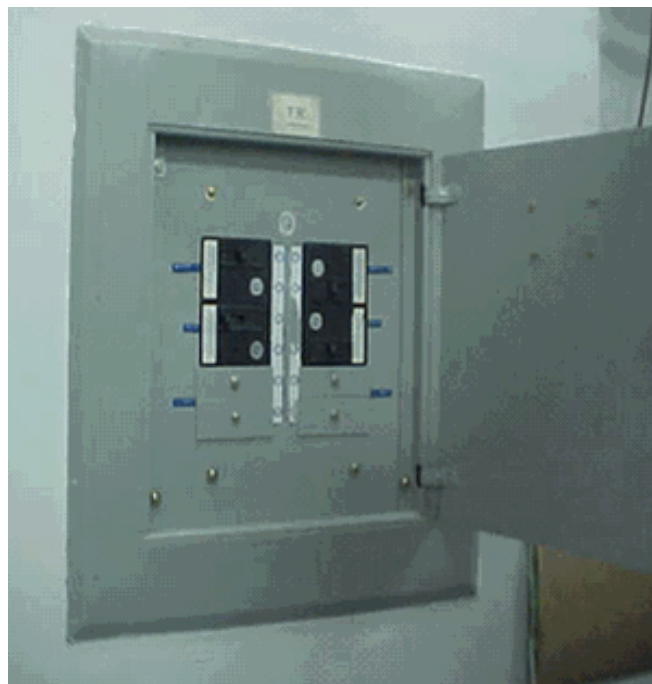
Figura 3.12 Caja térmica de breaker principal de alimentación
