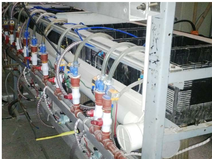
Figura 3.4 Sistema de tubería en las cubas
