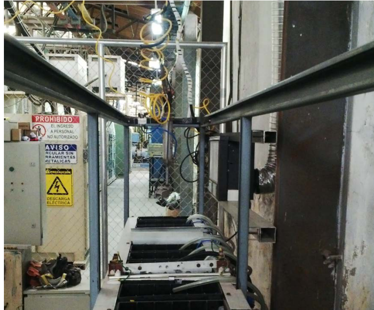
Figura 3.1 Cubas ubicadas en la estructura
