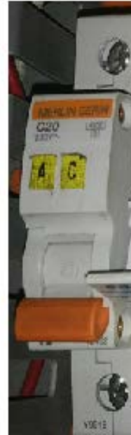
Figura 3.13 Breaker de alimentación principal
