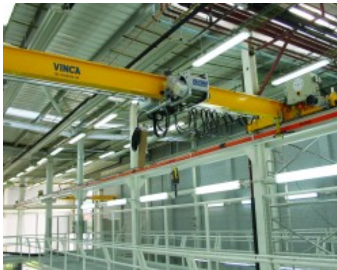
Figura 2.11 Puente grúa tipo monorriel
