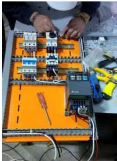
Figura 3. 39. Conexión eléctrico del tablero de protección.
