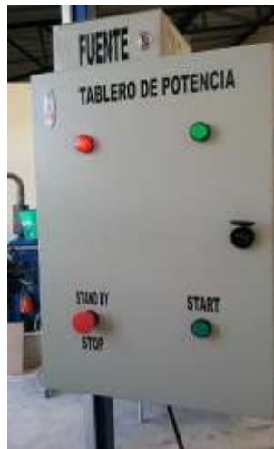
Figura 3. 41. Tablero de control finalizado
