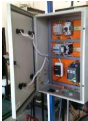
Figura 3. 40. Elementos montados en el tablero de protección
