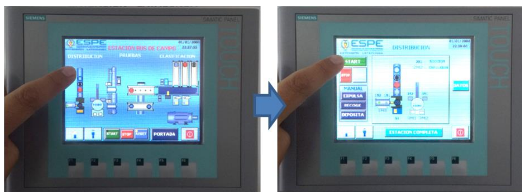
Figura 5.60. ingreso al control individual de la estación de distribución.
