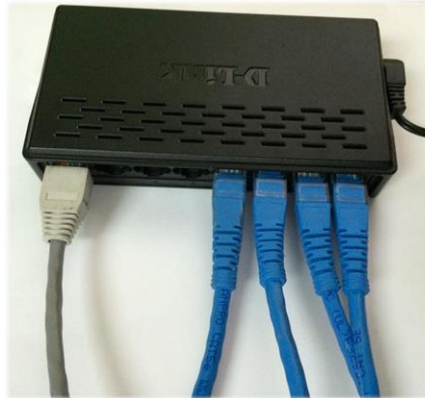
Figura 3.11. Conexión de cables en switch.
