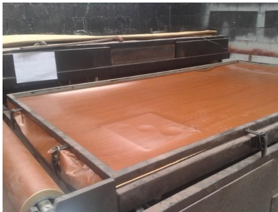
Figura 2. 27 Instalación de cámara de vacío y cámara de temperatura
