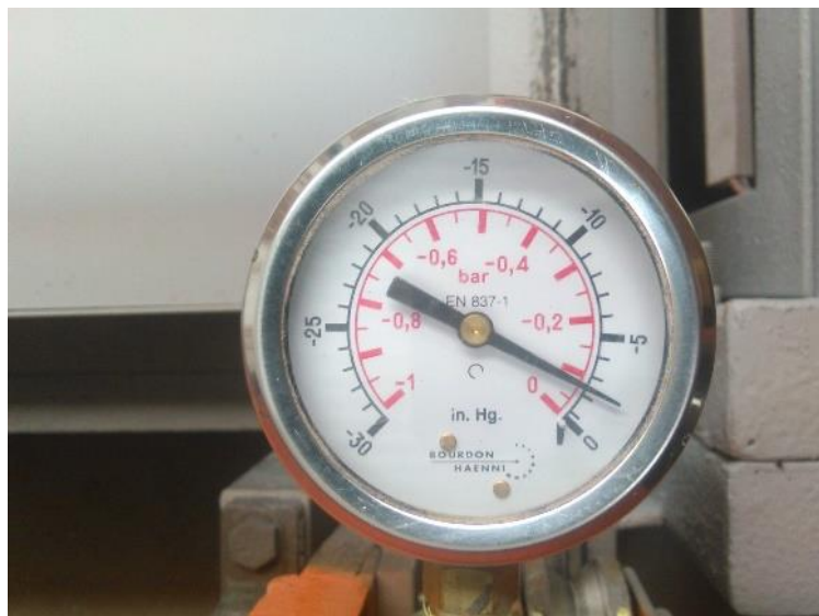
Figura 3.13 Presión adecuada de funcionamiento.
