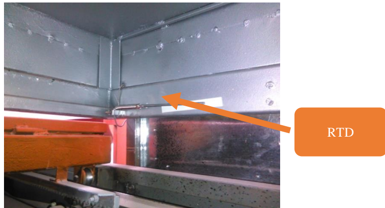
Figura 3.6 Medición de la temperatura uniforme en toda la cámara.
