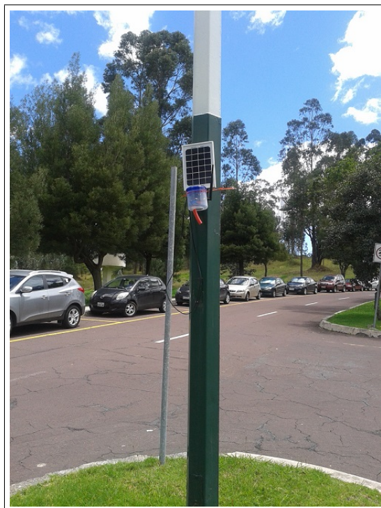
Figura 52: Colocación de los nodos en los postes de luz.
