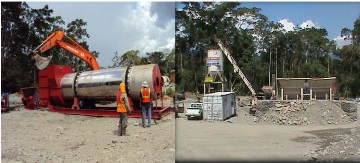
Figura 3.4.- Área de stock o de almacenamiento de agregados
