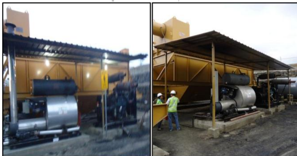
Figura 3.6.- Área de máquinas
