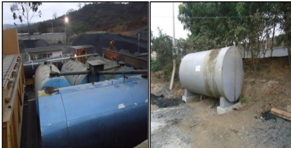
Figura 3.7.- Tanques de almacenamiento de asfalto y combustible
