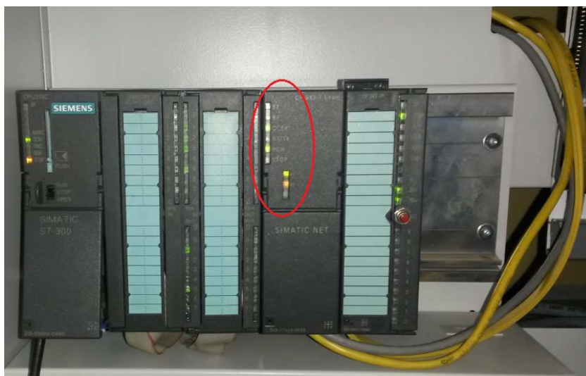
Figura 3.17: Módulo Ethernet CP 343-1 Lean listo para su funcionamiento
