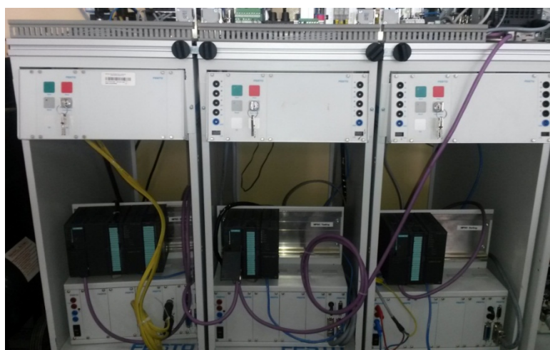
Figura 3.5: Cables de conexión para la Red Profibus
