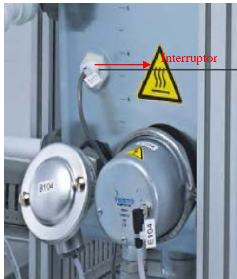
Figura 2.13: Interruptor flotador tanque inferior
