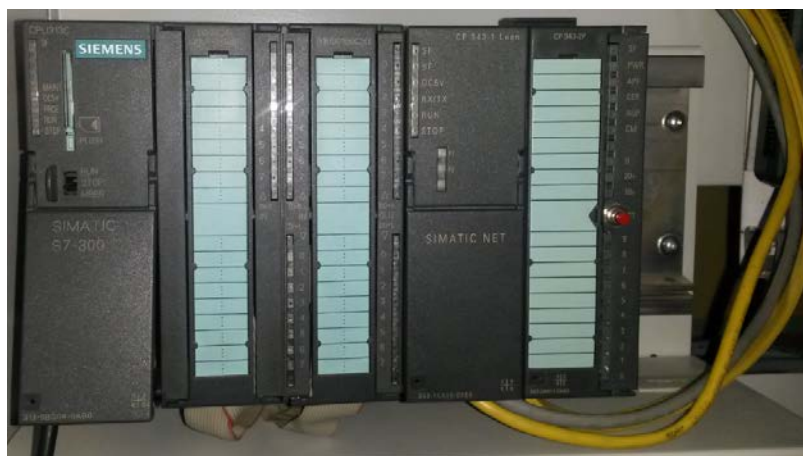
Figura 3.4: PLC S7-300 con los módulos de comunicación
