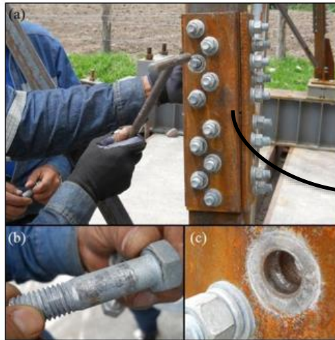
Figura 135. Inspección de placa más crítica en Torre SP2+3; (a) extracción de muestras; (b) superficie marcada por el perno; y (c) inspección de borde de agujero.
