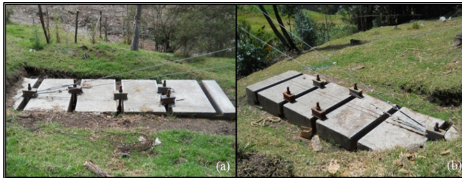
Figura 26. Cimentación para cables de carga y soporte. (a) cimentación de carga transversal y soporte; (b) cimentación de carga longitudinal y soporte.
