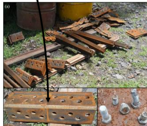
Figura 138. Placas de interés desmontadas y pernería; (a) Placas interiores y principales; (b) Placa interior de unión más crítica a compresión y (c) pernos de acuerdo a condición de desmontaje
