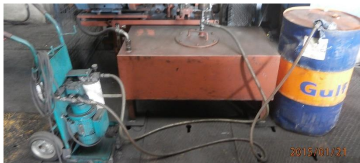
Figura 3.4.- Reservorio de sistema hidráulico.
