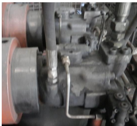
Figura 3.2.- Bombas de sistema hidráulico.
