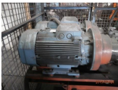
Figura 3.1.- Motores sistema hidráulico.
