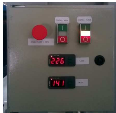
Figura 102 Caja de Control de las Resistencias Eléctricas
