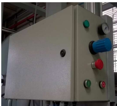
Figura 97 Caja de Control de los Cilindros Neumáticos
