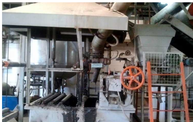
Figura 13 Balsa de Impregnación de la Línea de Producción de la Empresa Chova del Ecuador
