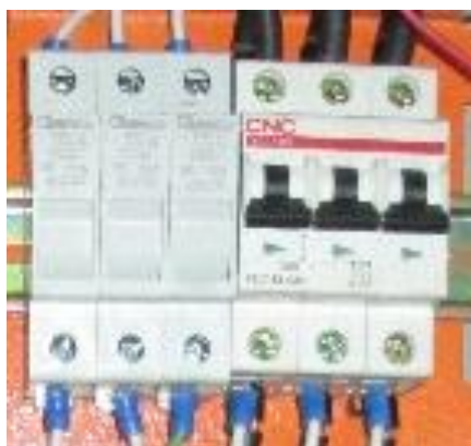
Figura 85 Fusibles y breaker de protección
