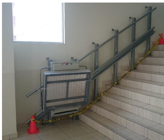
Figura 106. Implementación mecánica concluida
