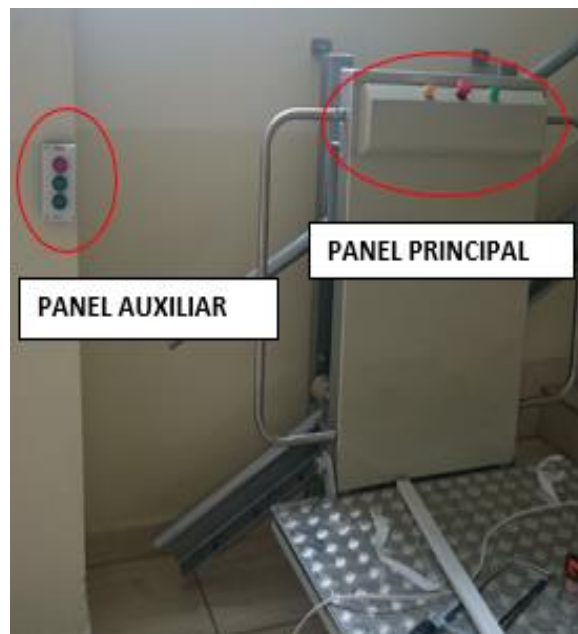
Figura 116. Paneles de control
