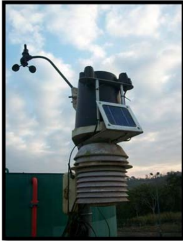
Figura 2.9 Estación meteorológica de OCP
