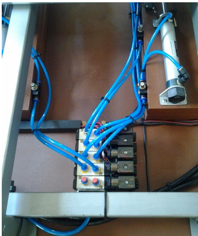
Figura 263. Evidencia de conexión neumática 3.
