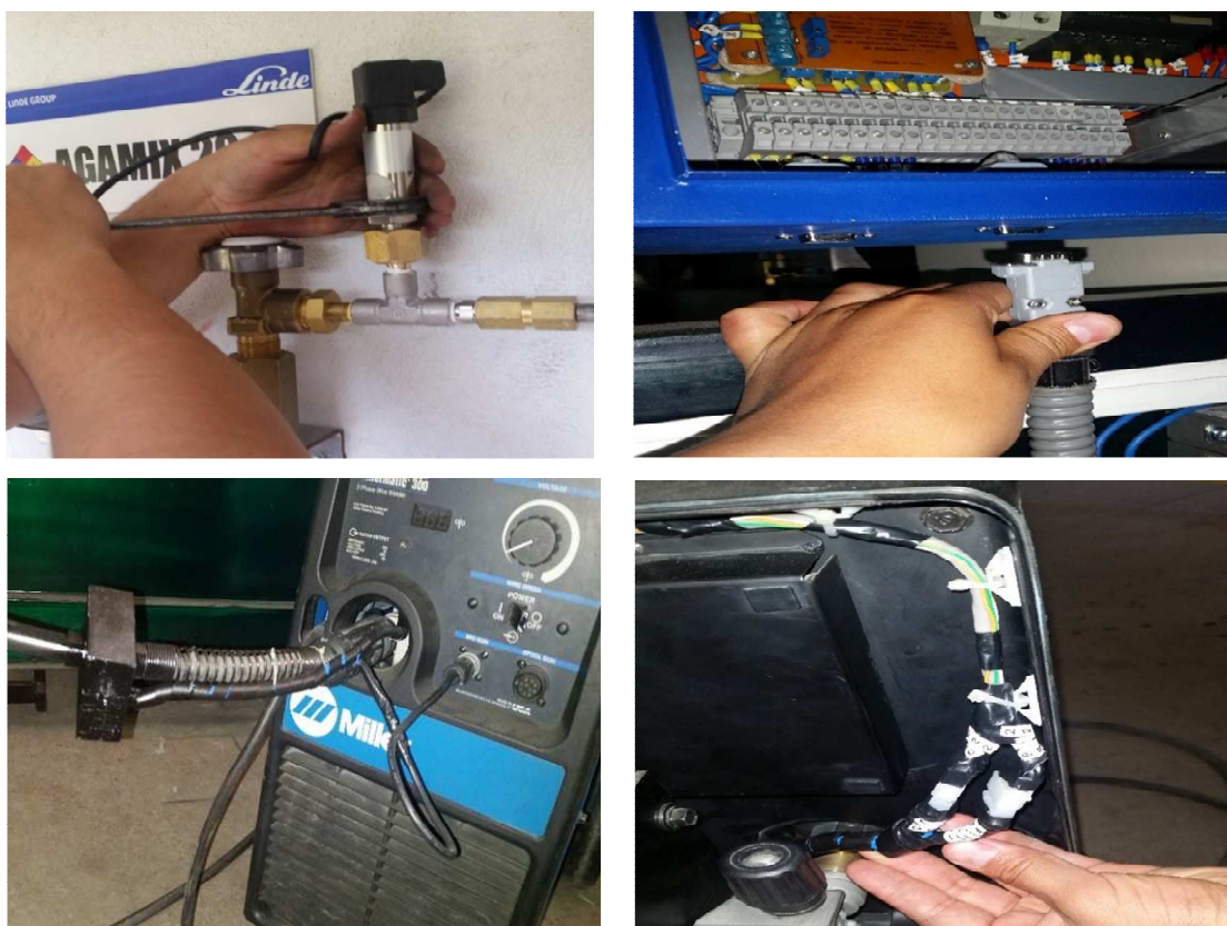
Figura 80. Conjunto de imágenes instalación de sensores
