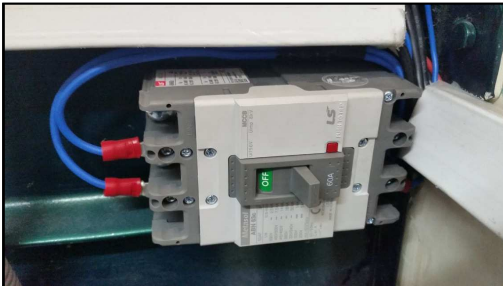
Figura 127. Interruptor principal apagado
