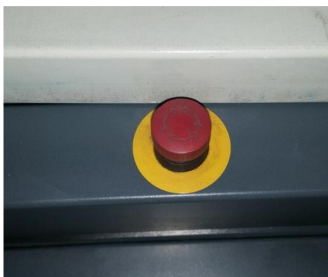
Figura 5.27 Paro de emergencia implementado en la procesadora
