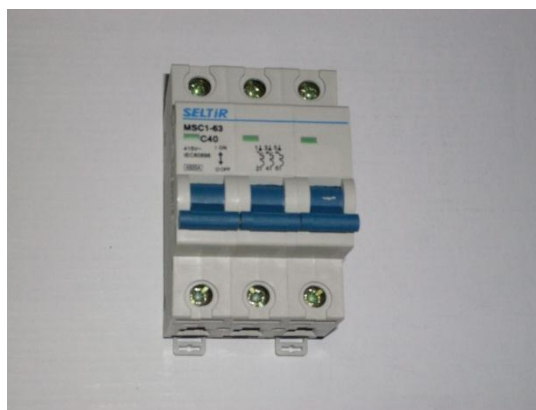
Figura 5.29 Disyuntor del sistema de emergencia
