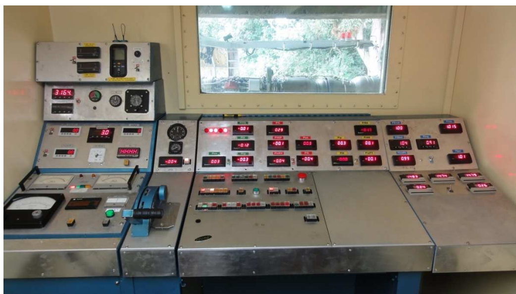
Figura 6. Indicadores de la cabina de control
