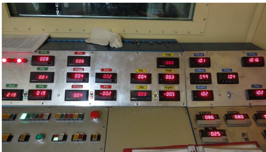
Figura 44. Valor de los instrumentos en el tablero de control
