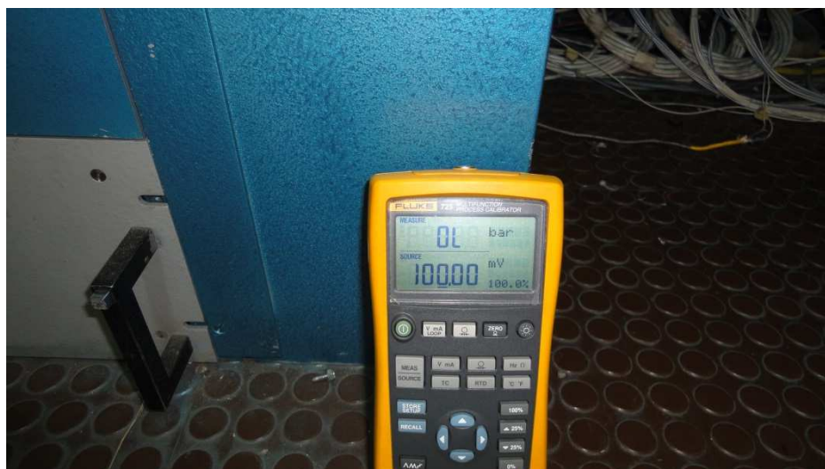
Figura 69. Equipo para inducir voltaje para comprobar el funcionamiento característico
