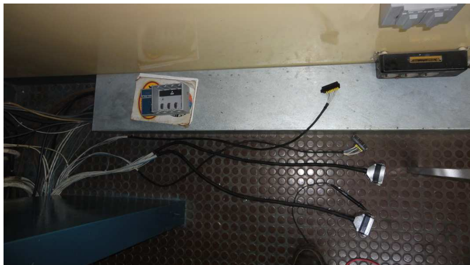
Figura 77. Acabado del cableado que va a los cuatro módulos
