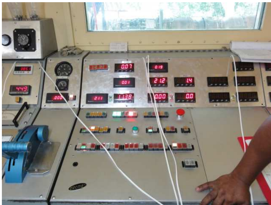
Figura 18. Tablero de instrumentos con conexión para la medición en operación
