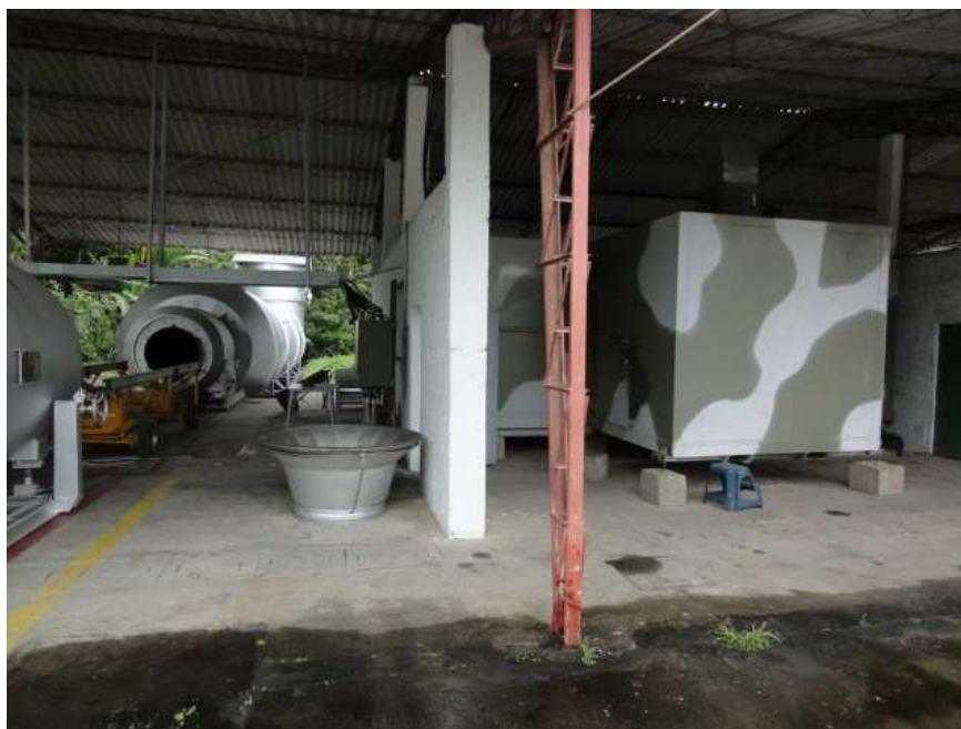
Figura 1. Banco de pruebas de motores ATAR 09K50
