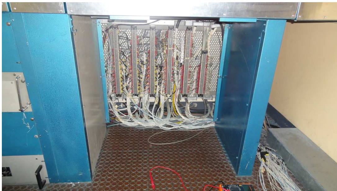
Figura 73. Tablero de barras de datos del banco de pruebas
