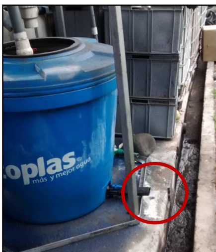
Figura 6: Descarga de Agua Remanente Generada en el Biodigestor.
