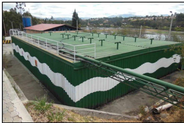
Figura 8: Tanque de almacenamiento de aceites usados
