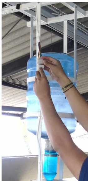
Figura 71. Desconexión de cables del sistema.
