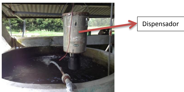
Figura 4. Piscina con dispensador fuera de funcionamiento.
