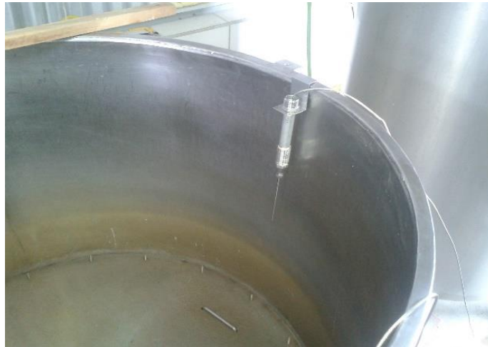
Figura 6.8: Sensor de temperatura en tanque de maceración.
