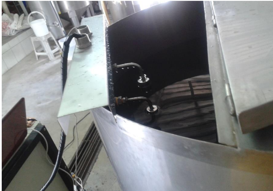
Figura 6.6: Controlador de nivel en tanque de calentamiento de agua.
