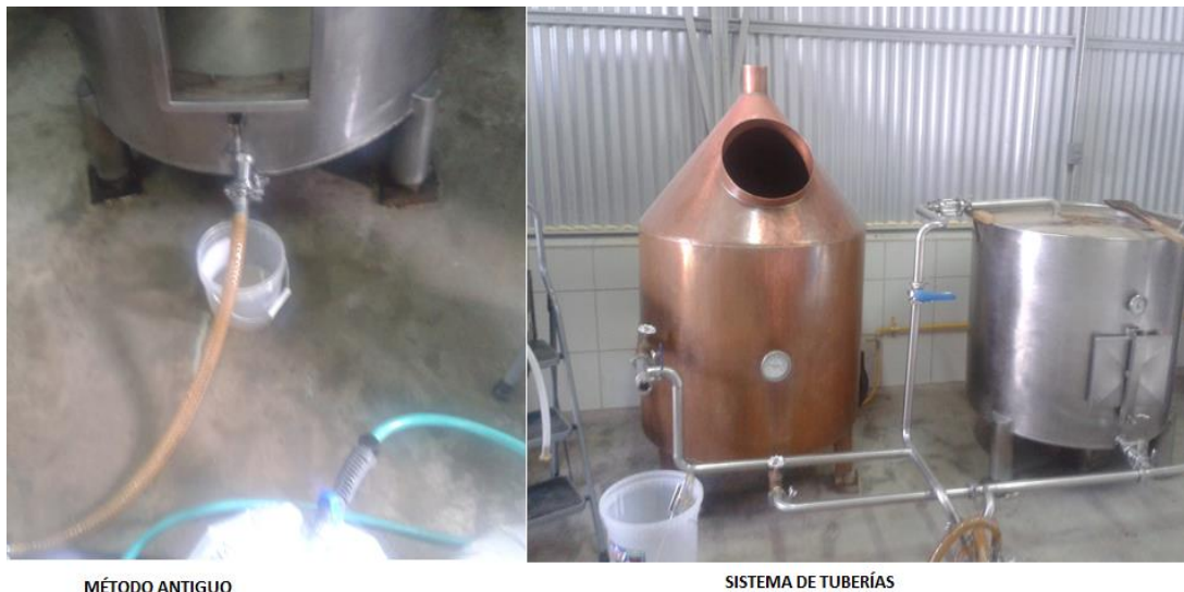
Figura 6.1: Sistema de tuberías.
