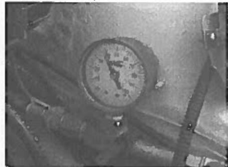
Figura 10. Manómetro para mediciones de presión del sistema de inyección.
