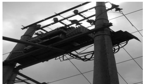
Fig. 1: Transformador de alimentación del Centro de Producción (80 KVA)
