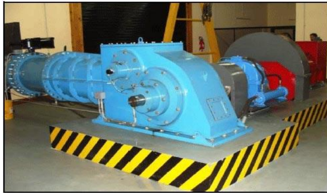
Figura 6: Grupo Turbina – Generador (turbina Michell Banki)
