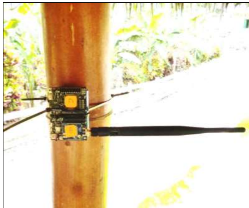
Figura 4.9 Acelerómetro LIBELIUM instalado en una columna del puente.
