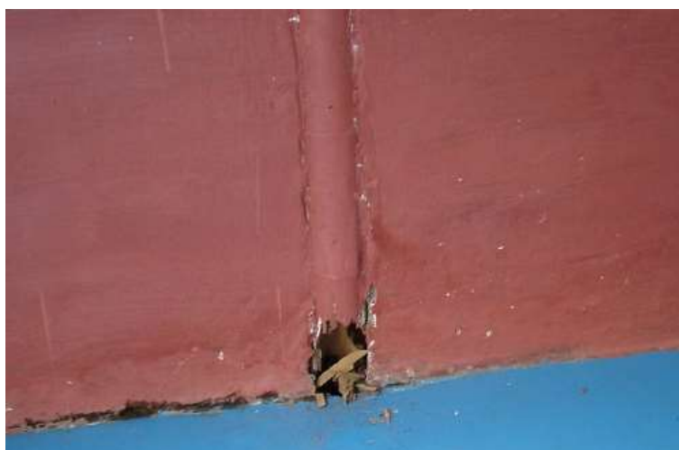
Figura 6.13. Resultado negativo de la embebida de GAK directamente en una pared (FUNDEGUADUA A. , 2010).
