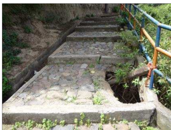
Figura 103. Escalinata en mal estado
