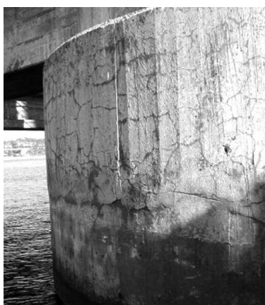
Figuran 25: Estructuras afectadas por la RAS.
