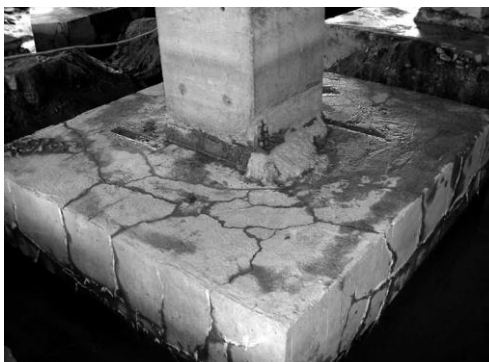
Figura 24: Fisuras en mapa causadas por la RAS en una cimentación.
