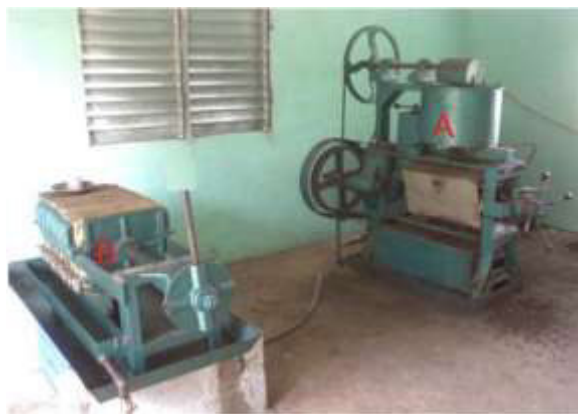
Fig. 2 Sistema máquina extractora (A) – filtros (B).
