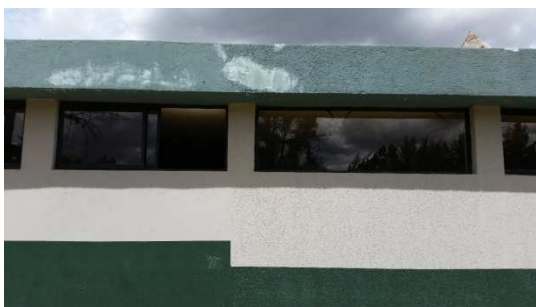
Figura 4 Columna Corta. Baños Aulas C.E.D.E
