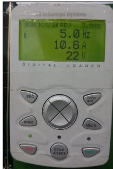
Figura 46. Módulo de activación bomba de alta presión.
