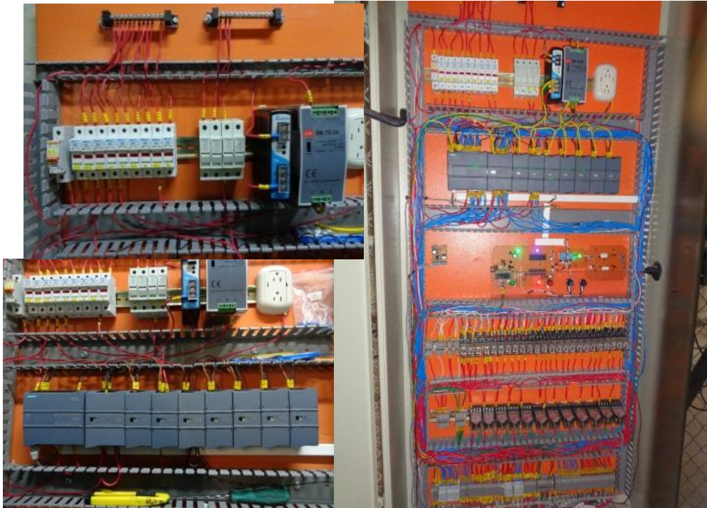
Figura 72 Tablero de control listo.
