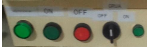
Figura 66 Pulsadores e indicadores de control.
