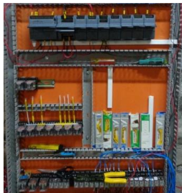
Figura 68 Conexión y etiquetación de cableado.
