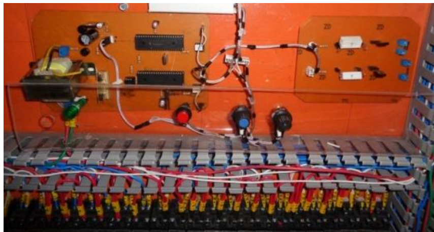
Figura 69 Instalación de la tarjeta electrónica de disparo de SRC'S.
