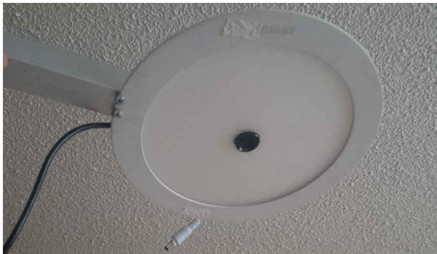
Figura 90 Implementación de la cámara e iluminación
