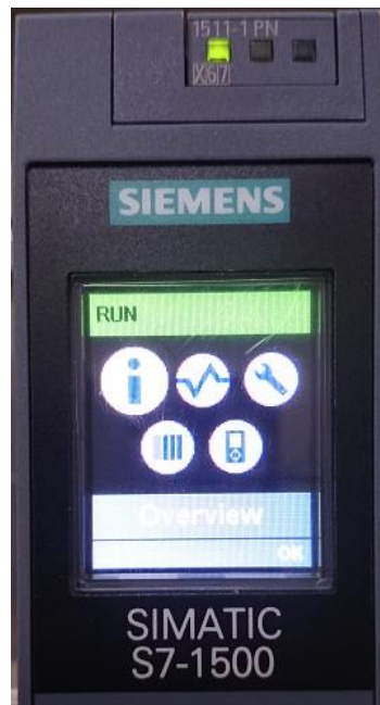
Figura 137.- Pantalla PLC S7-1500, estado RUN.
