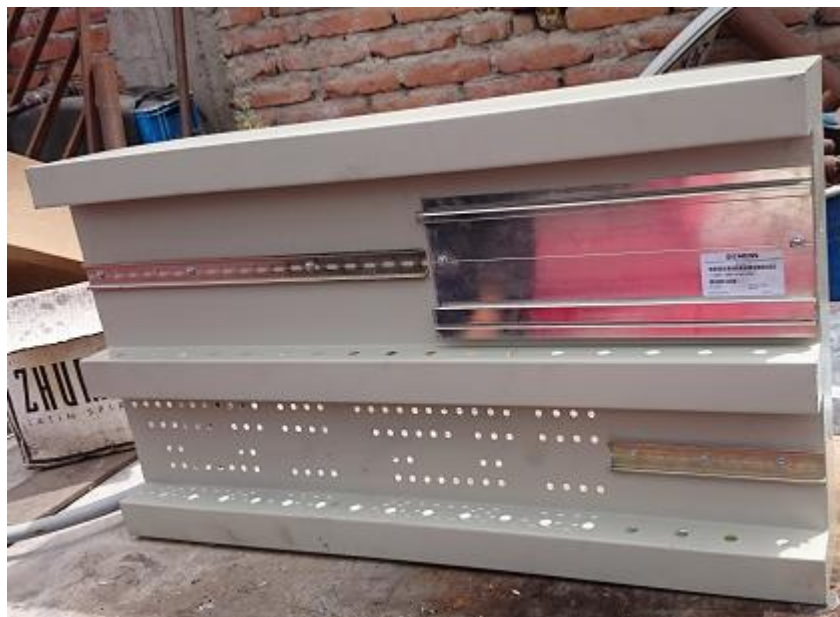
Figura 84.- Tablero eléctrico construido.
