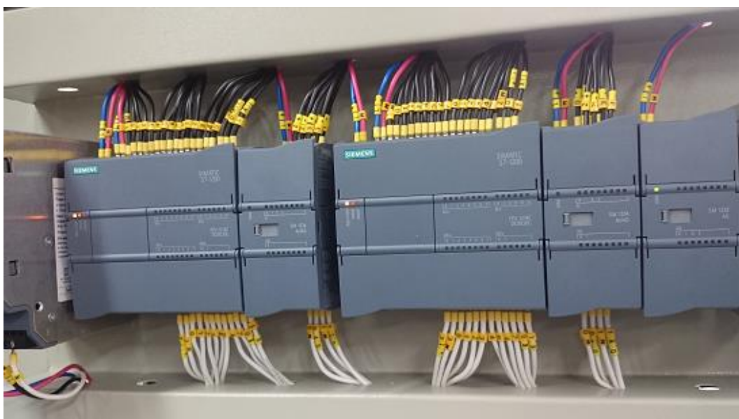
Figura 90.- Cableado de Dispositivos.
