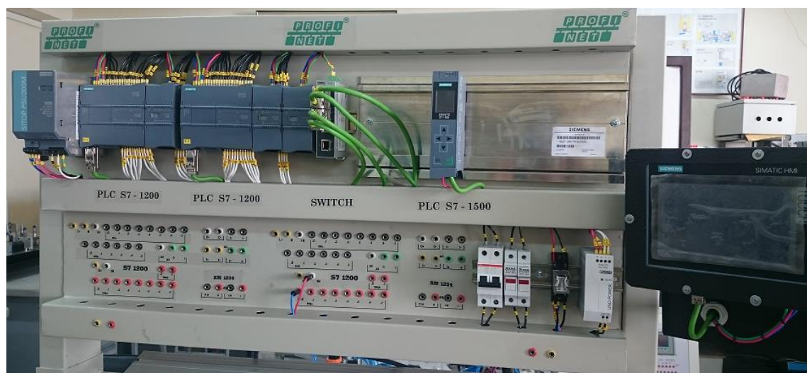
Figura 94.- Sistema de Red Profinet instalado.
