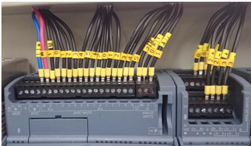
Figura 89.- Cableado PLC S7-1200 y Módulo SM 1234.
