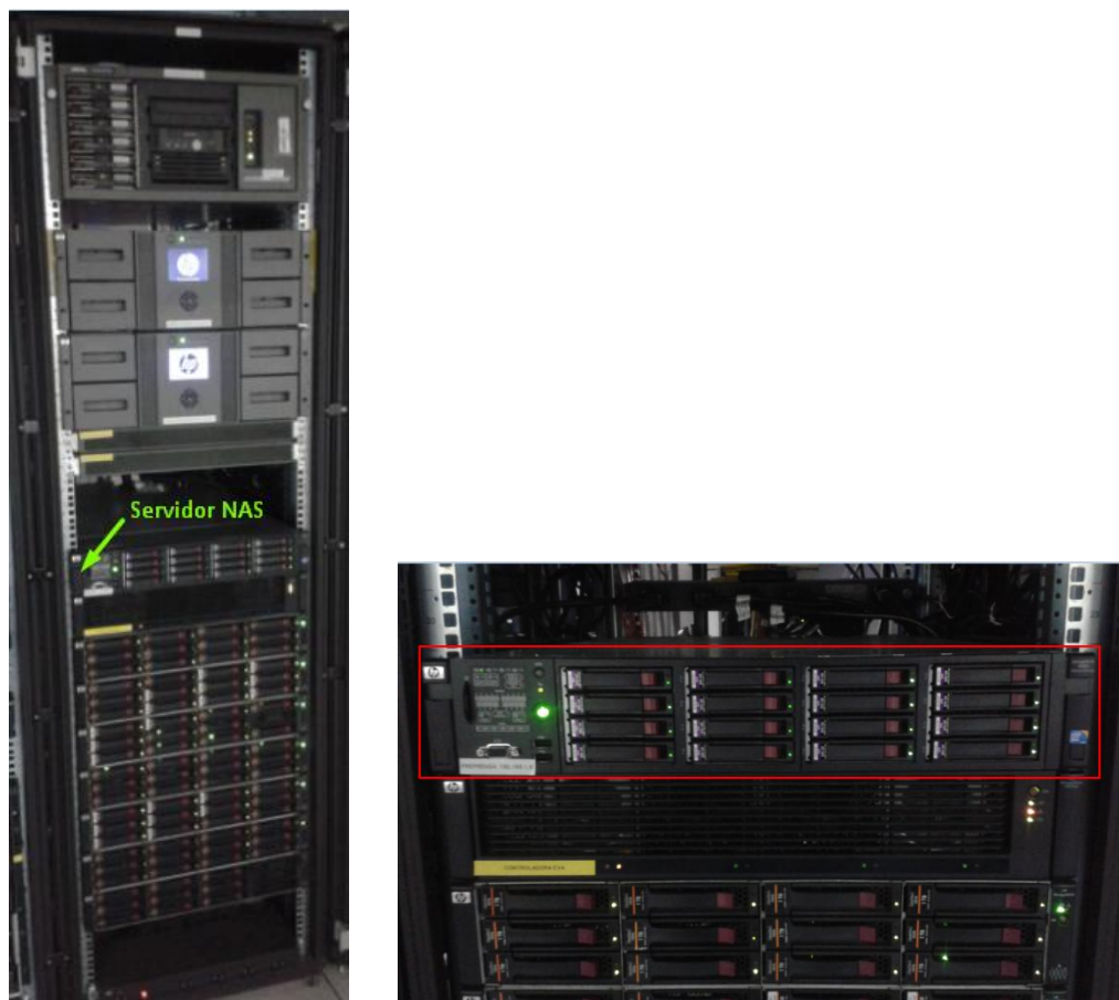
Figura 31 Servidor NAS montado en el rack DCUIO06 de Grupo El Comercio
