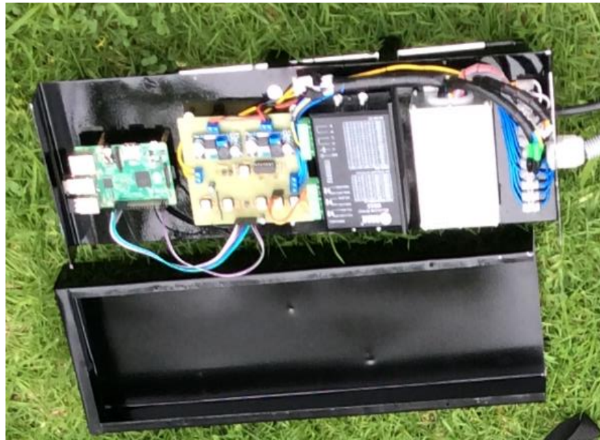
Figura 143. Distribución del cableado.
