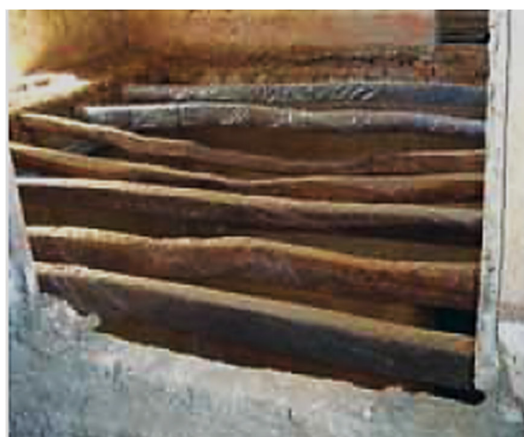
Figura 46 Vigas deformadas, por lesiones mecánicas, Fuente: (Peñaranda, 2011).
