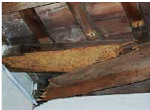
Figura 47 Ruptura de una viga, por sobre peso, Fuente: (Peñaranda, 2011)
