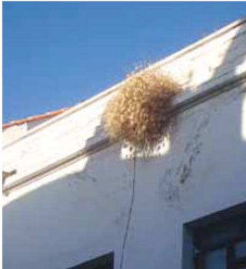
Figura 41 Biodeterioro, causado por humedad Fuente: (Peñaranda, 2011).
