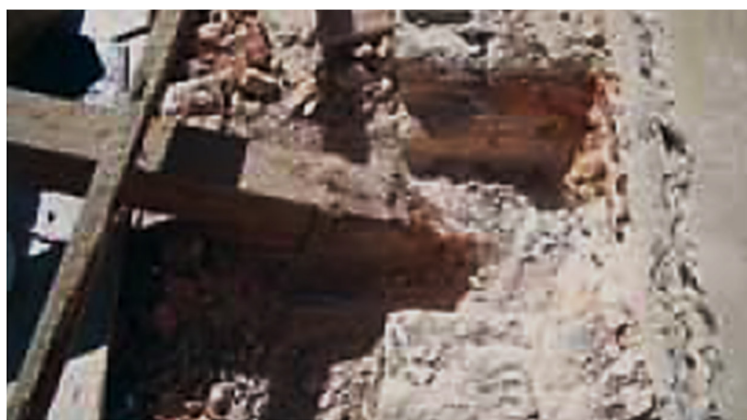
Figura 44 Cabeza de viga con pudrición severa, Fuente: (Peñaranda, 2011).
