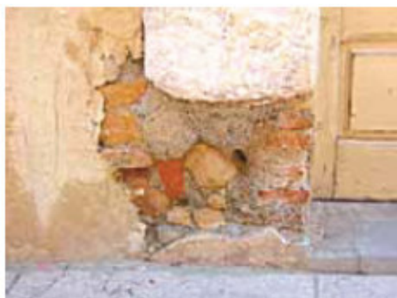
Figura 37 Deterioro de cimientos por humedad capilar Fuente: (Peñaranda, 2011).
