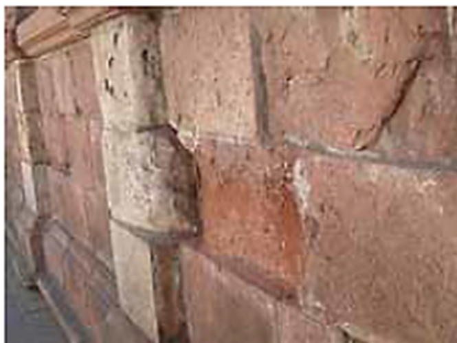
Figura 38 Erosión de la piedra por factores medio ambientales Fuente: (Peñaranda, 2011).
