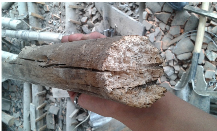
Figura 45 Madera afectada por termitas.
