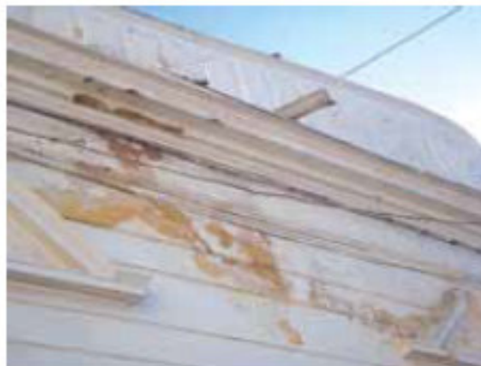
Figura 42 Humedad descendente. Fuente: (Peñaranda, 2011).
