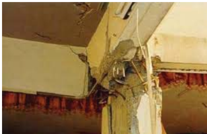
Figura 36: Falla de corte unión viga-columna Terremoto 1985, Ciudad de México 1985 Fuente: (Nereida, 2008)
