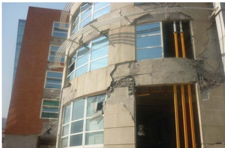
Figura 32: Falla de unión viga-columna, Terremoto 27 de febrero del 2010, Santiago Chile Fuente: (Larraín, 2011)
