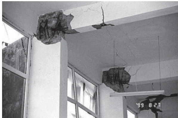
Figura 23: Falla de unión viga-columna, Terremoto 17 de agosto de 1999, Koacaeli Turquía
