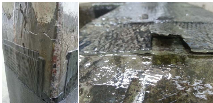
Figura 155: Falla cabeza de columna
