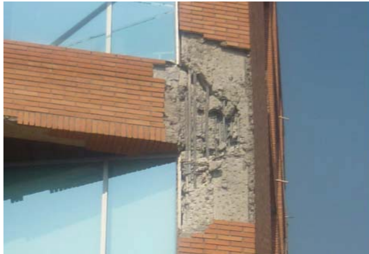
Figura 33: Falla de unión viga-columna Terremoto 27 de febrero del 2010, Santiago Chile Fuente: (Larraín, 2011)
