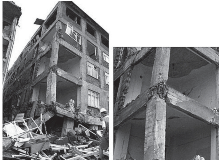
Figura 3: Falla de unión viga-columna, terremoto 17 de agosto de 1999, Kocaeli Turquía Fuente: (Aguiar, Revelo, & Tapia, 2013)
