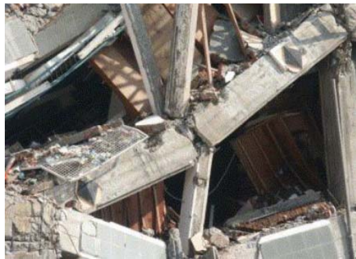
Figura 24: Falla de unión viga-columna (Centro Comercial "Panta Pirák" en Banda Aceh, Terremoto y tsunami, 26 de diciembre de 2004)
