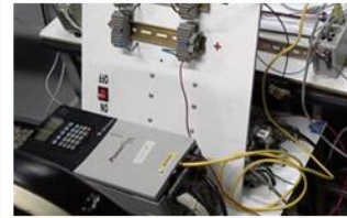
VSD variador PowerFlex 700 en el switch
