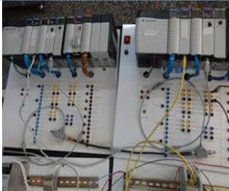
Conexión ControlNet entre L61
