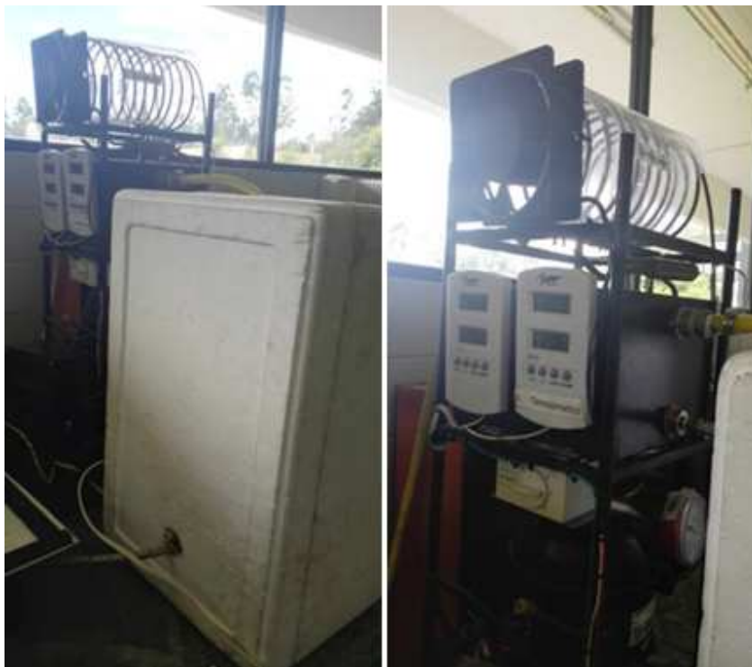
Figura 27. Equipo de refrigeración
