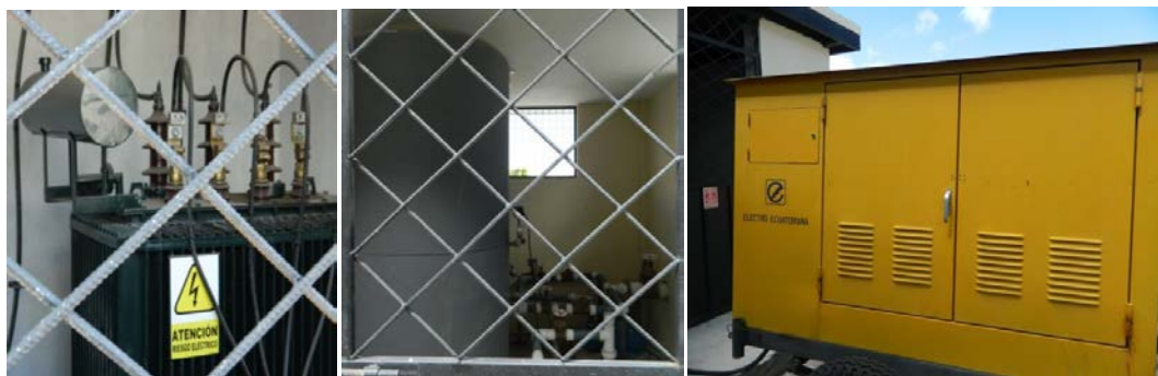
Fotografía 8. Área de generación de energía
