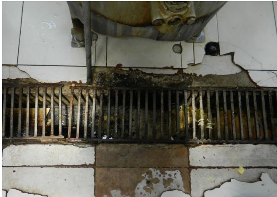
Fotografía 13. Rejillas de evacuación de desechos de cocina
