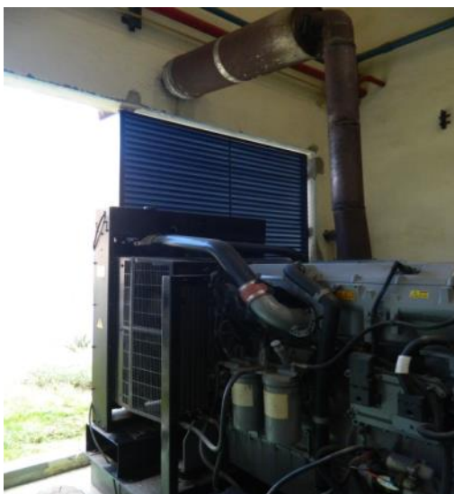
Fotografía 17. Generador eléctrico de emergencia
