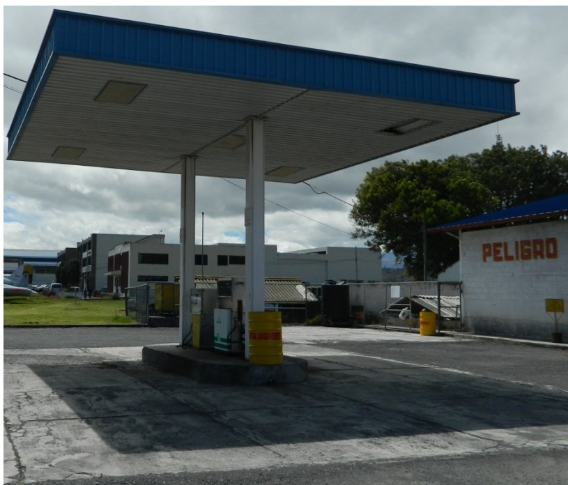
Fotografía 18. Área de distribución y almacenamiento de combustibles
