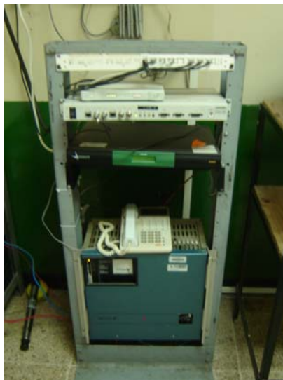
Figura. 2.4. Rack de comunicaciones de Cabecera (PCO).
