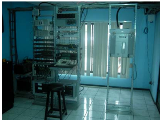
Figura. 3.9. Cuarto de Equipos de la Estación EL Beaterio.
