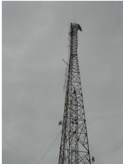
Figura. 2.7. Torre de Comunicaciones de PIN (Antenas de Cabecera y Sucursal respectivamente).
