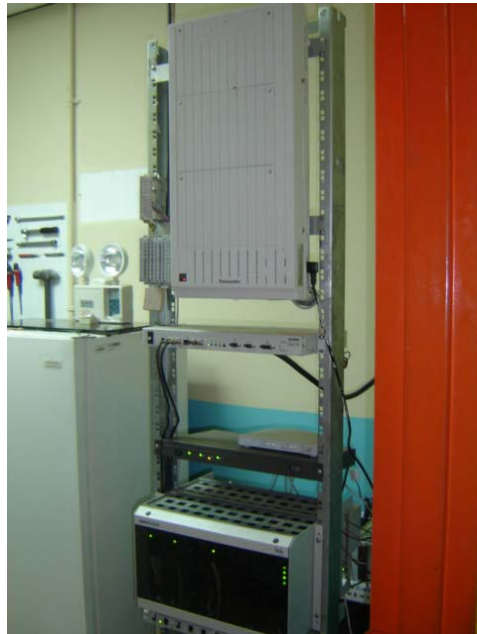
Figura. 2.12. Rack de Comunicaciones en la Estación de Quijos.
