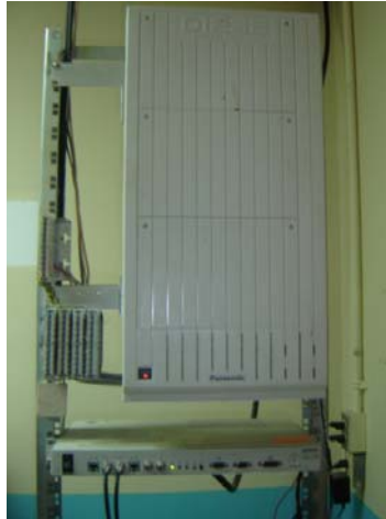
Figura. 2.13. Central Telefónica de la Estación Quijos.
