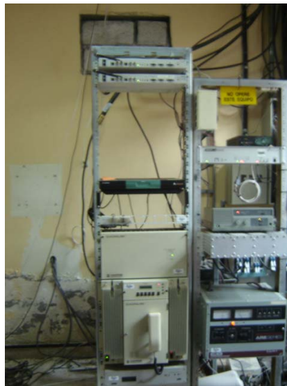
Figura. 2.6. Rack de Comunicaciones de PCO.
