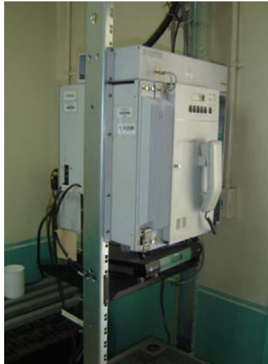
Figura. 2.16. Rack de Comunicaciones de la Estación Osayacu.
