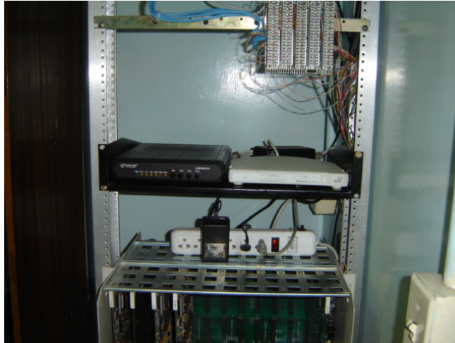
Figura. 2.20. Rack de Comunicaciones de Estación Chalpi.
