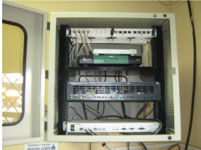
Figura. 2.2. Rack de comunicaciones de Sucursal (PCO).
